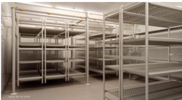
Interior de cámaras de frío
