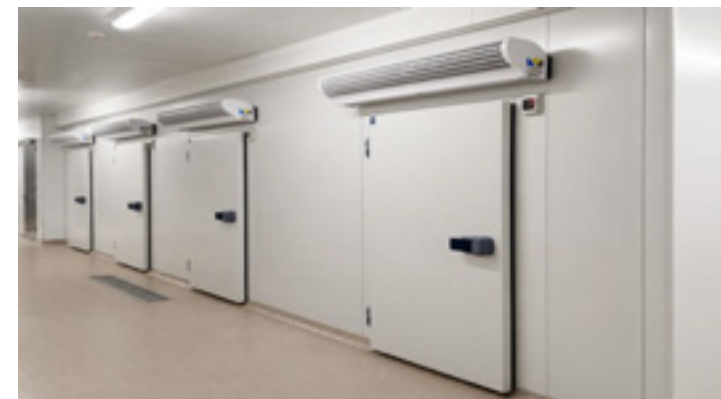
Cámaras de frío
